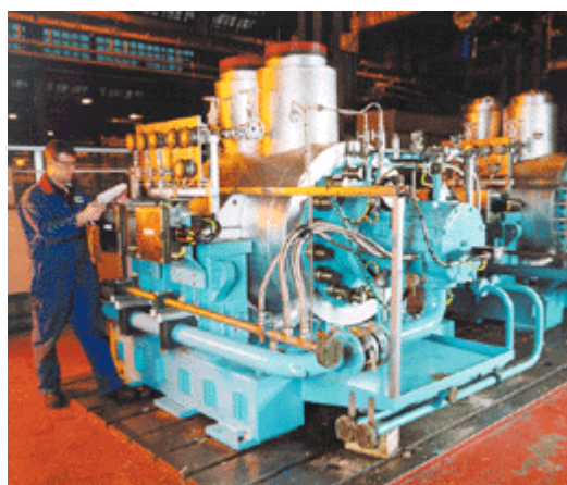
图12. 马来西亚的Manjung电厂锅炉给料泵(Weir泵有限公司特许刊登)
